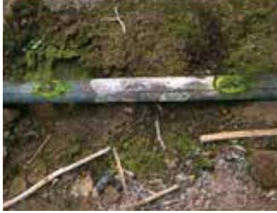
Colmatage causé par les algues.
